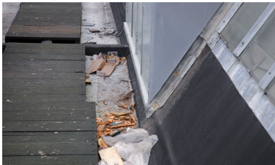
De nieuwe gootbekleding heeft het ondanks de bescherming zwaar te verduren.
