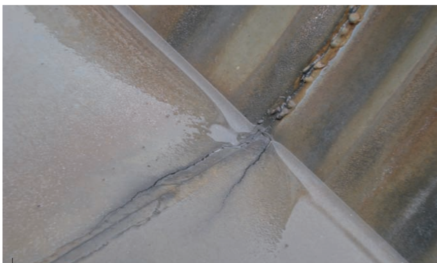
Scheurvorming naast soldeerwerk.
